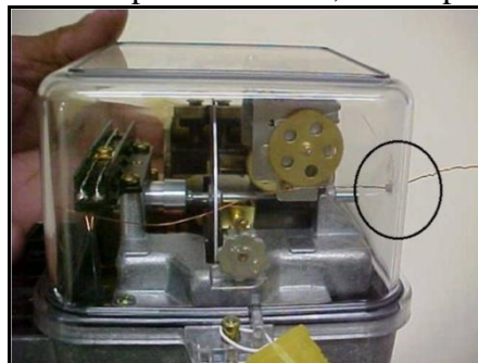
Figura 4 – Vista lateral da tampa do medidor, com a presença objeto estranho
