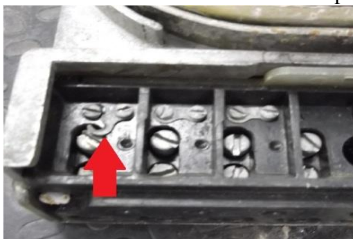
Figura 6 – Bloco de terminais com terminal de prova aberto
