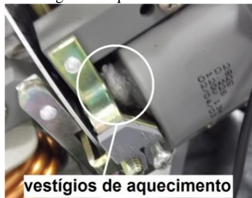
Figura 12 – Vestígios de aquecimento na bobina de tensão
