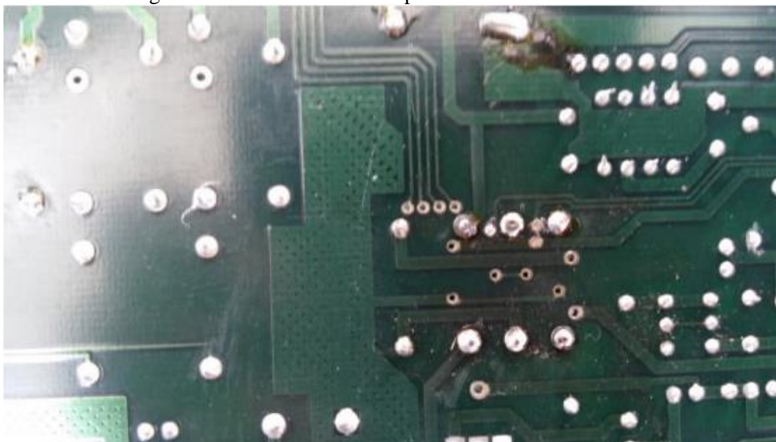
Figura A29 – Vista traseira da placa com trilhas adicionais.
